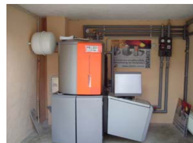
Fertig installierte Anlage
